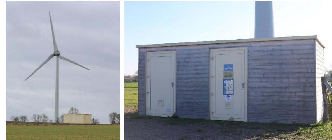
Figure 18 : Exemples de poste de livraison électrique
